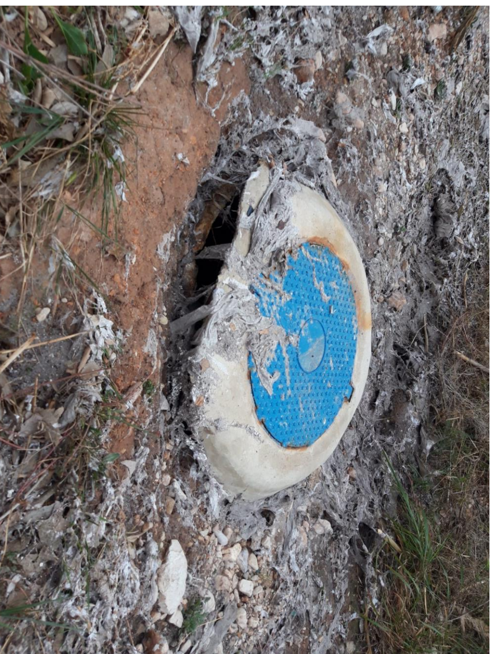
Imagen 8. Pozos existentes en el interior del cauce. Estado con fisuras por donde desborda en caso de lluvias
