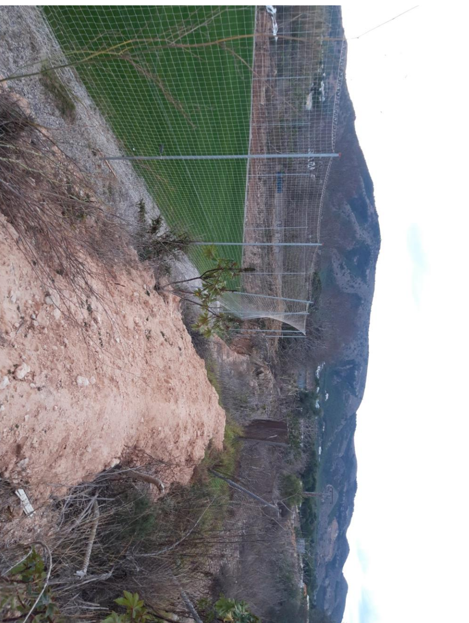
Imagen 4. Talud margen izquierdo del barranco, separador del campo de fútbol.
