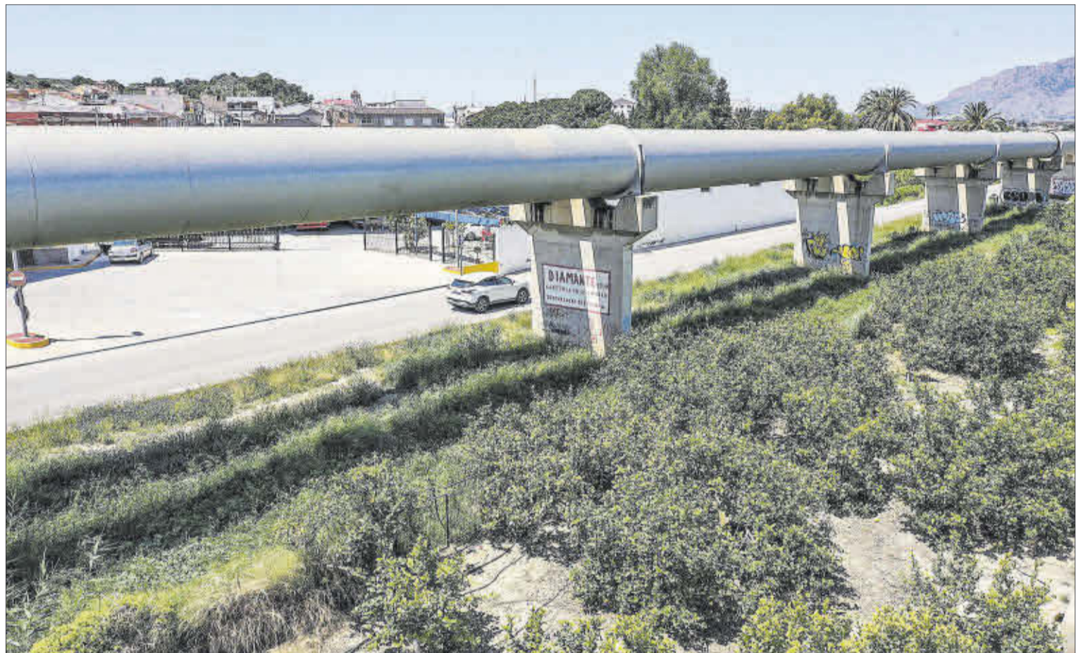
Imagen de la tubería del trasvase Tajo-Segura a su paso por la Vega Baja.
